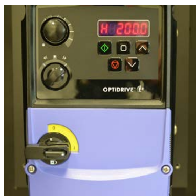
Fig. 8d Schakelaar 3 op 200 Hz
